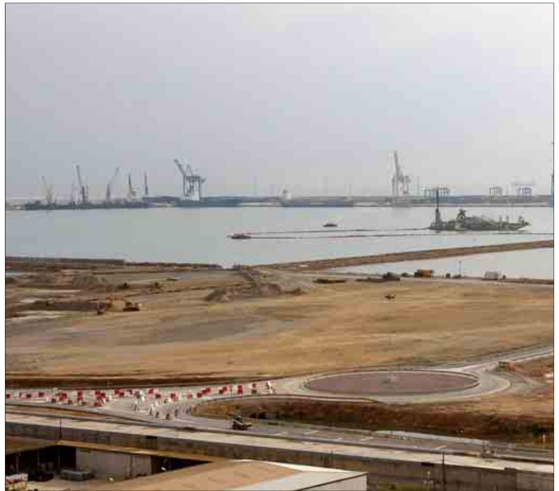
Dársena sur del puerto de Castellón, con los accesos en obras. / JUAN MARTÍ
